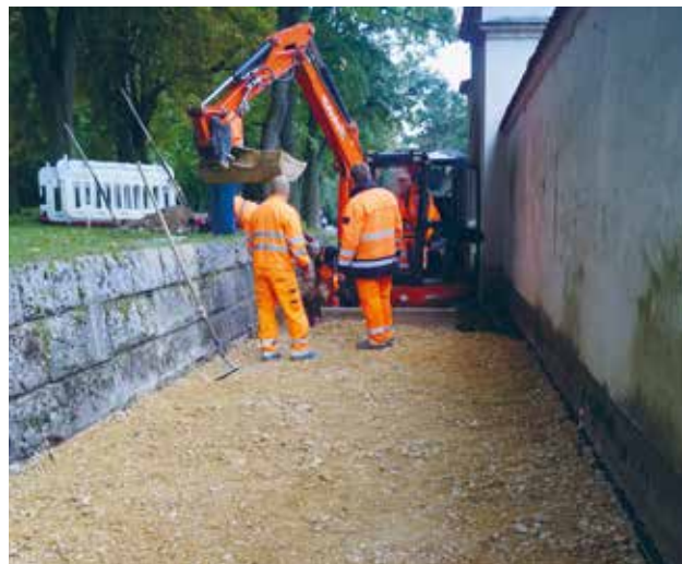
Abb. 54: Der alte Oberbau ist in der Regel zu stark verdichtet
