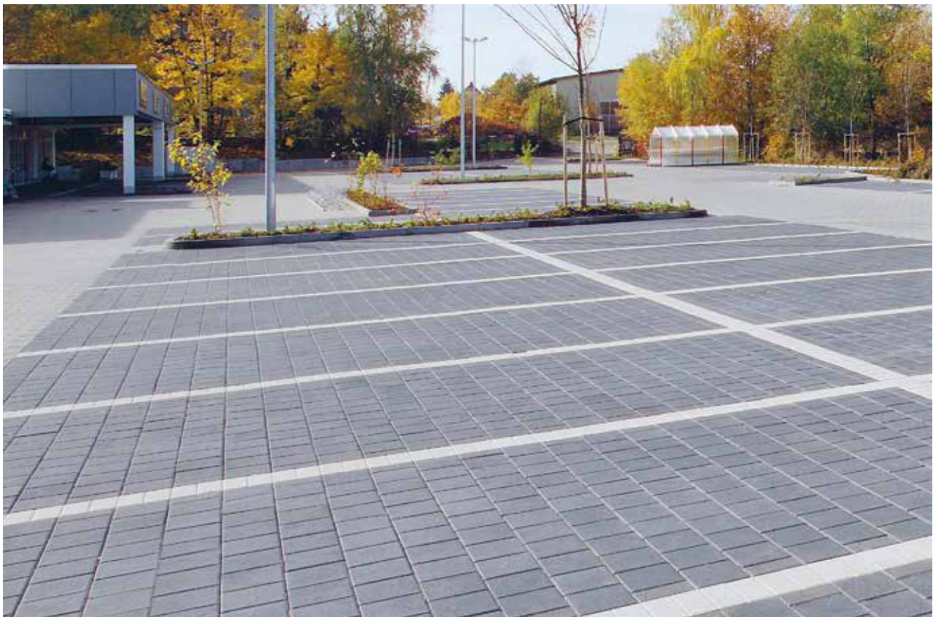
Abb. 06: Auf Großparkplätzen können besonders hohe Schadstoffbelastungen entstehen
