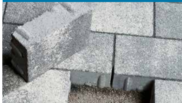
Abb. 28: Das Wasser versickert über die Fuge
