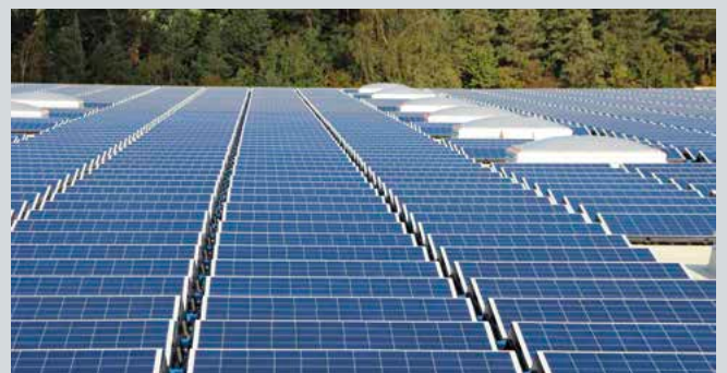
Abb. 5/3: Industrie-Leichtdach mit Photovoltaik-Anlage
